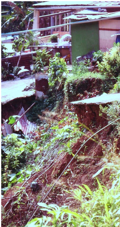
Photo 9 : La terrasse de cette maison a été détruite par un glissement au passage des pluies de la tempête Iris (1995), sur les hauteurs du Lamentin (Martinique). Cliché E. Bénito-Espinal.
