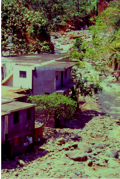
Photo 1 : Des habitations dans le lit torrentiel de la rivière aux Herbes (Basse-Terre, Guadeloupe), après l'inondation due au passage du cyclone Marilyn (septembre 1995). Cliché E.Bénito-Espinal.
