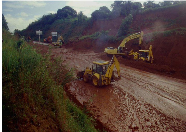
Photo 8 : RN2 (route nationale reliant Pointe-à-Pitre à Basse-Terre), submergée par un glissement de terrain après de fortes pluies en novembre 2004. Cliché E. Bénito-Espinal.
