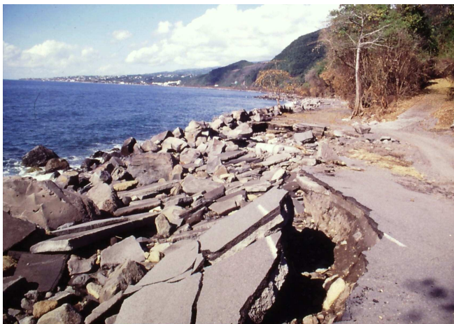
Photo 6 : Route littorale de Vieux-Fort (Guadeloupe), endommagée par les houles de Lenny (1999). Cliché E. Bénito-Espinal.
